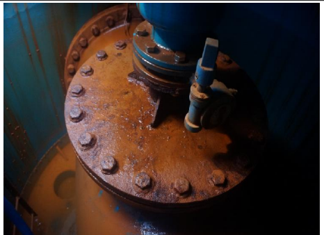
배관 및 마개F 상태
