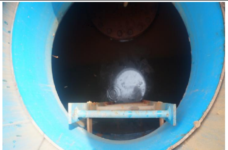
밸브실 내부 전경
